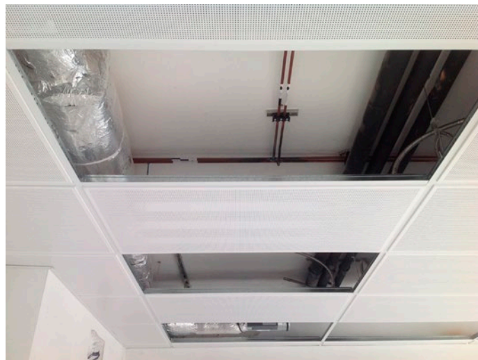
Figura 8. Dettaglio sistema radiante a soffitto con pannelli aperti (Fonte: Fraccaro Officine Termotecniche)
