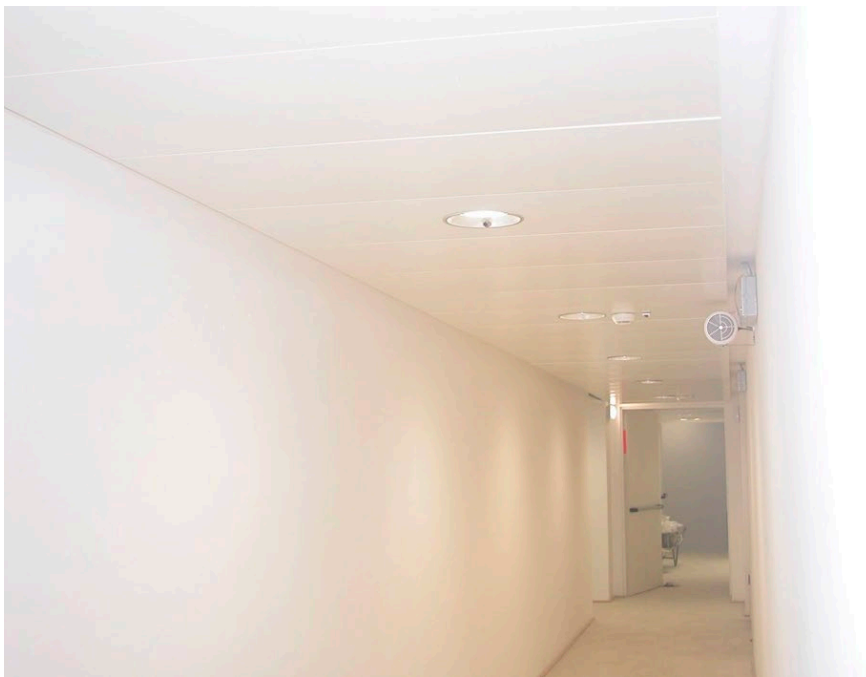
Sistema radiante a soffitti in edificio ospedaliero. Fonte: Fraccaro Officine Termotecniche
