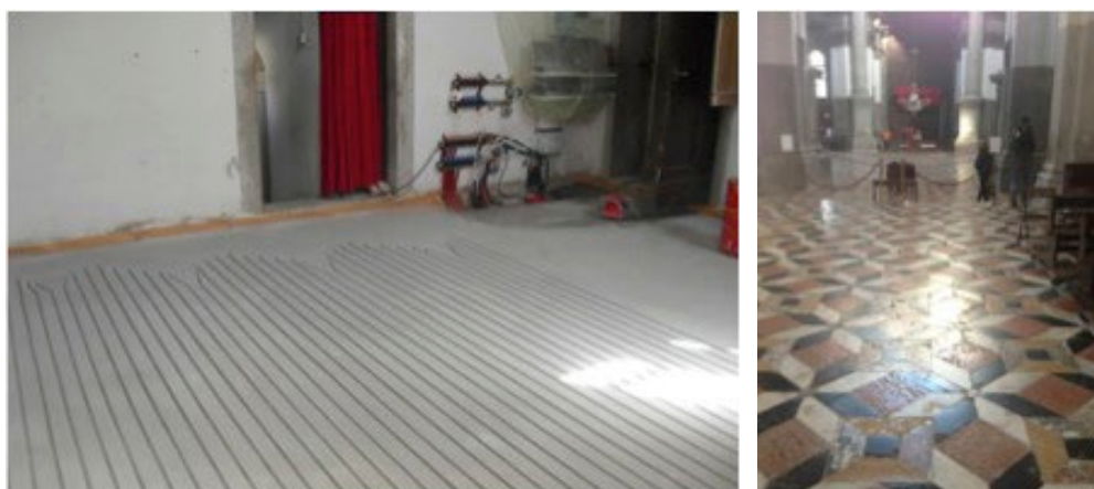
Figura 5. Chiesa della Salute a Venezia. Ristrutturazione 2013. Sistema radiante fresato; pavimentazione storica in marmo.
